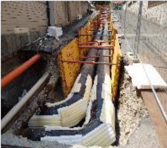
Tratto di rete in ingresso al punto di consegna presso Grugliasco
