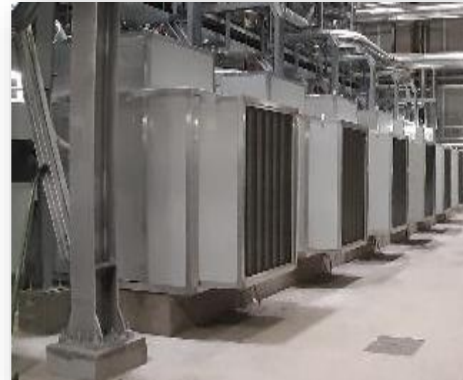
Sistema di pompaggio presso il Termovalorizzatore
