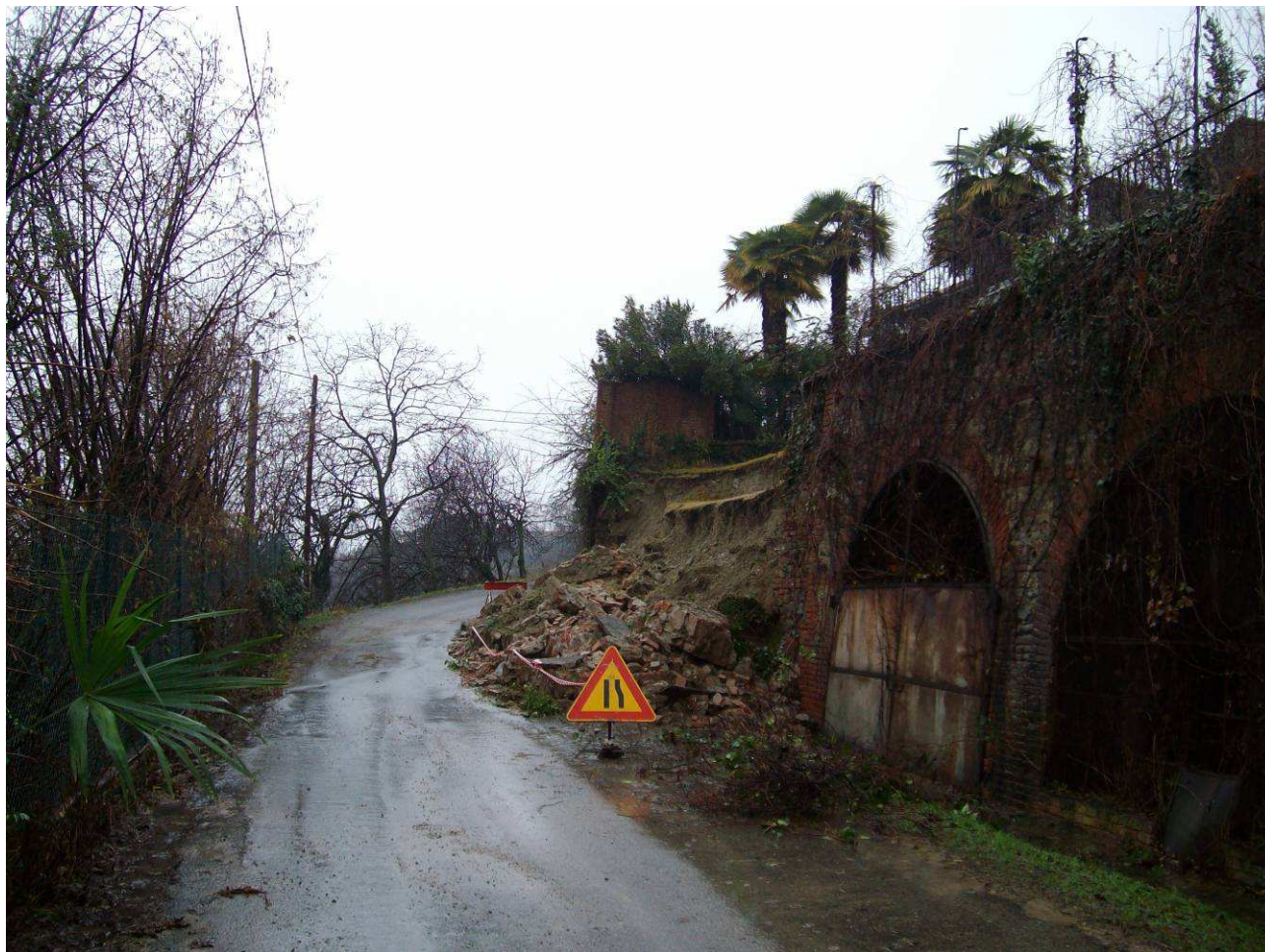
Panoramica della frana che ha interrotto la strada comunale.
