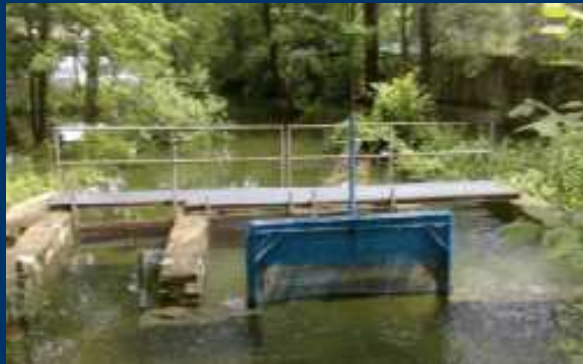
messa in funzione di un sistema di prelievo ipolimnico a costo "zero"
