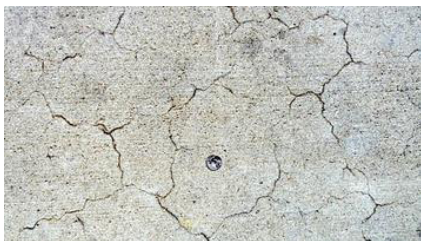
Esempio di fessurazione precoce nel cls: le dimensioni delle fessure sono confrontate con quelle di una moneta
