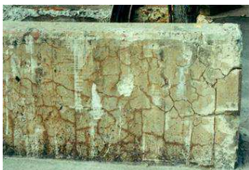
Esempio di degrado del cls dovuto alla AAR
