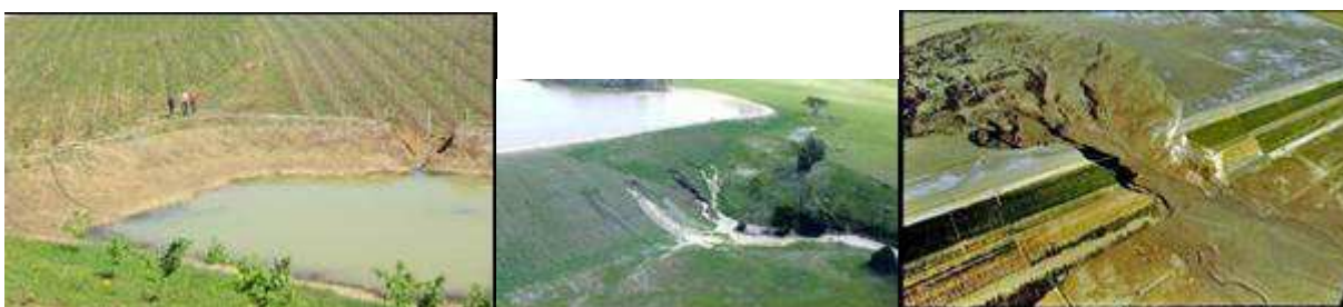
Esempio di rottura su sbarramenti di piccola dimensione
