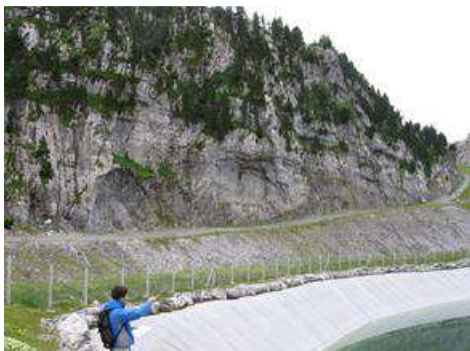
Sbarramento in quota soggetto a crolli in roccia
