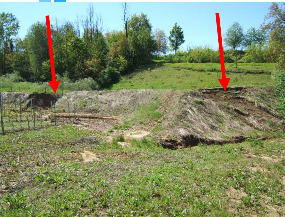
Sifonamento ed erosione interna
