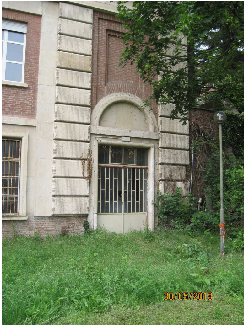
Serramenti da sostituire
