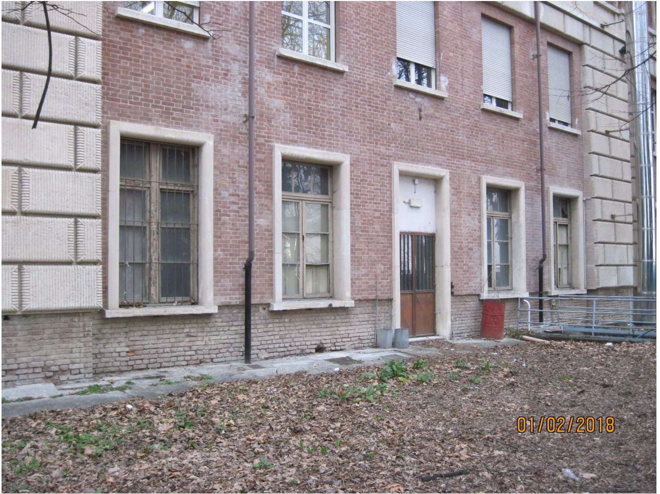
Serramenti esterni da sostituire
